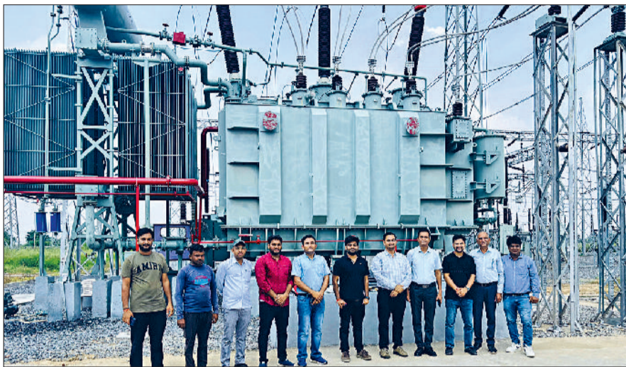
रेवाड़ी। लूला अहीर के पावर स्टेशन में लगाया गया ट्रांसफार्मर।
